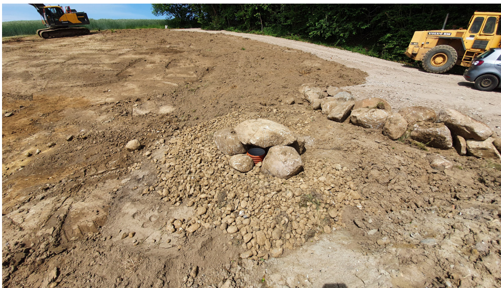
På billede 6 ses overløbet, som er placeret højere i terrænet end underløbet og tæt på vejterræn. Foto: Christian Bruun Bundesen
